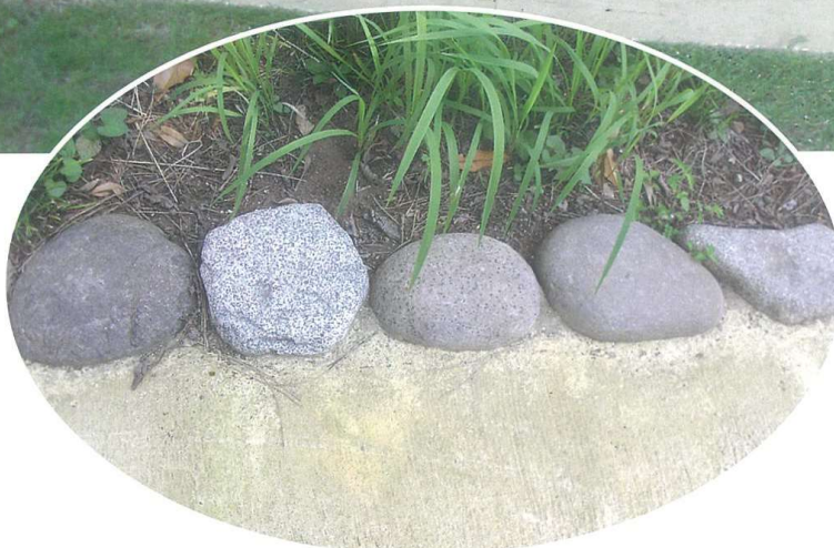
緑石間のヘアークラックが発生しにくい
